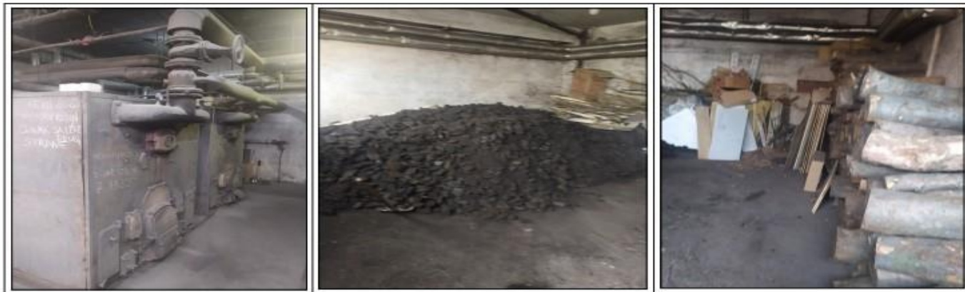
Слика 7. Котлови и магацини котларнице
